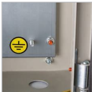
Шпилька заземления на монтажной панели.
